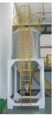
製品タンク Product tank
